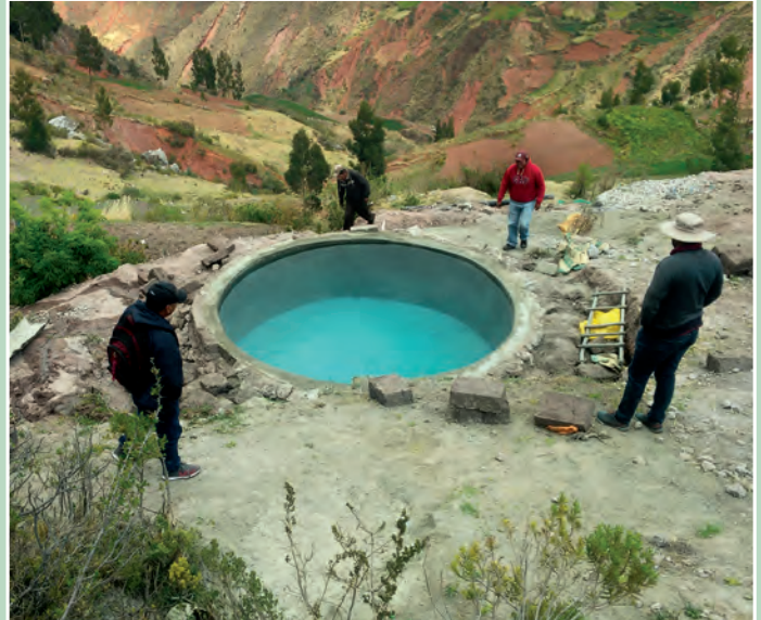
Foto: Sistemas familiares de riego tecnificado.
